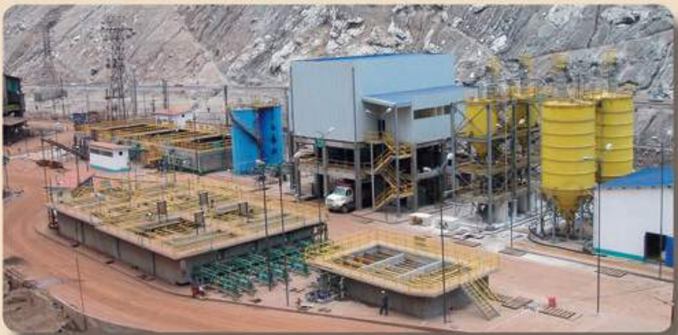
Vista de la Planta de Tratamiento de Aguas Industriales en el interior del Complejo Metalúrgico de La Oroya.
